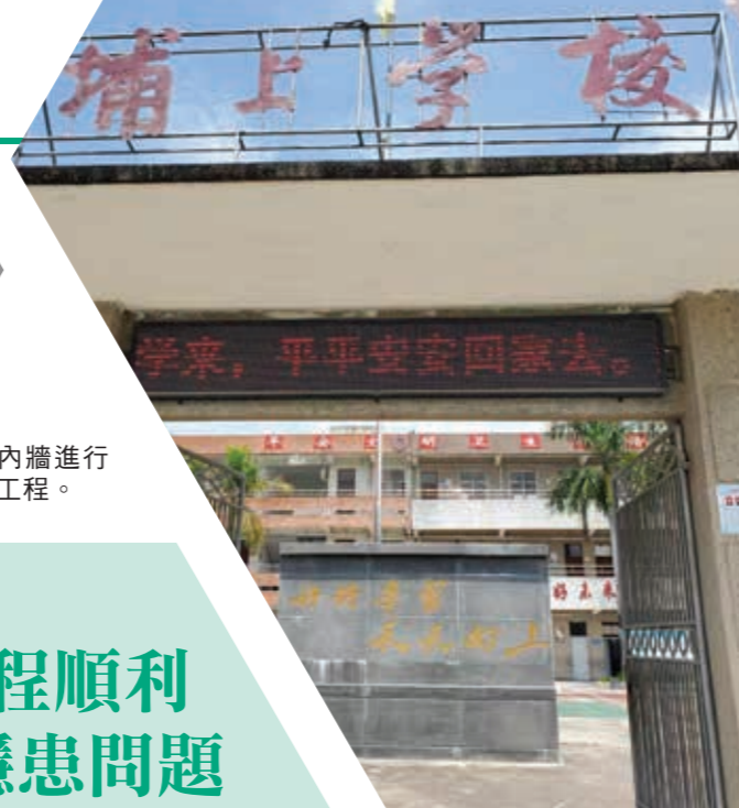
▲ 埔上小學建於上世紀50年代，教學樓日久失修，存在嚴重的安全隱患。
