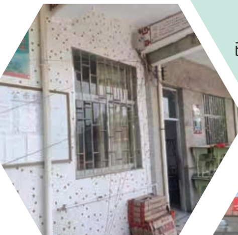
▲ 課室外雜亂的老舊電線。
